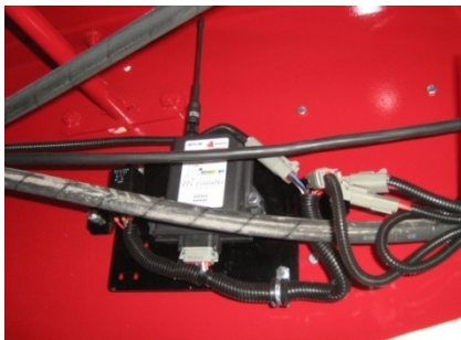
Figure 62 – Le récepteur de la conduite à distance
