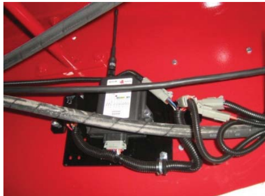
Figure 62 – Le récepteur de la conduite à distance
