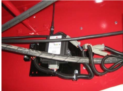
Figure 62 – Le récepteur de la conduite à distance
